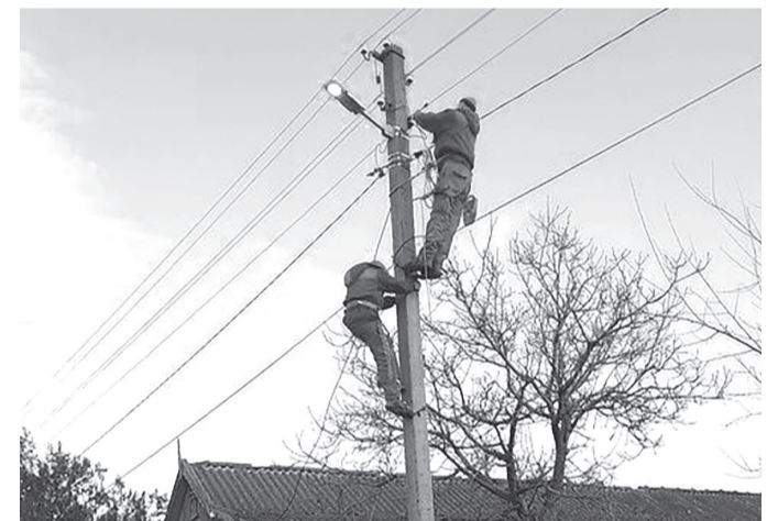
Iluminatul public din satele Calfa, Roșcani și Telița va fi extins
